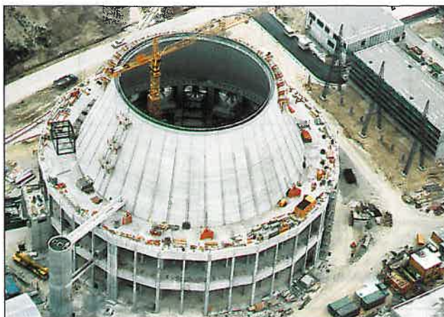
Abb. 16: Hybridkühlturm GKN II
